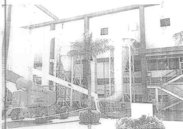
Foto 1. Izq – der.: Ciclones instalados para el control de emisión de material particulado arrastrado desde las actividades de secado y enfriado respectivamente.
